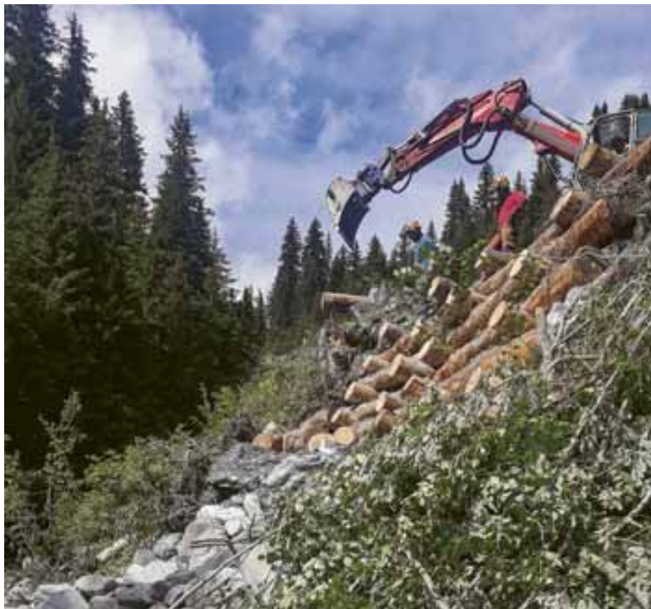
Bau von Holzkasten in der Val da Siat (SIS Val da Siat).
